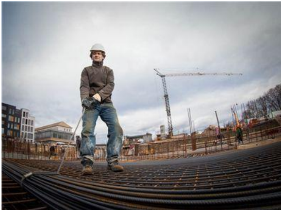
Eisenflechter Tano Caridi montiert mit seinen Kollegen derzeit die Stahlbewehrung für die Tiefgaragendecke im Herzogin Garten. Im Herbst 2017 soll der gesamte Komplex fertig sein.
